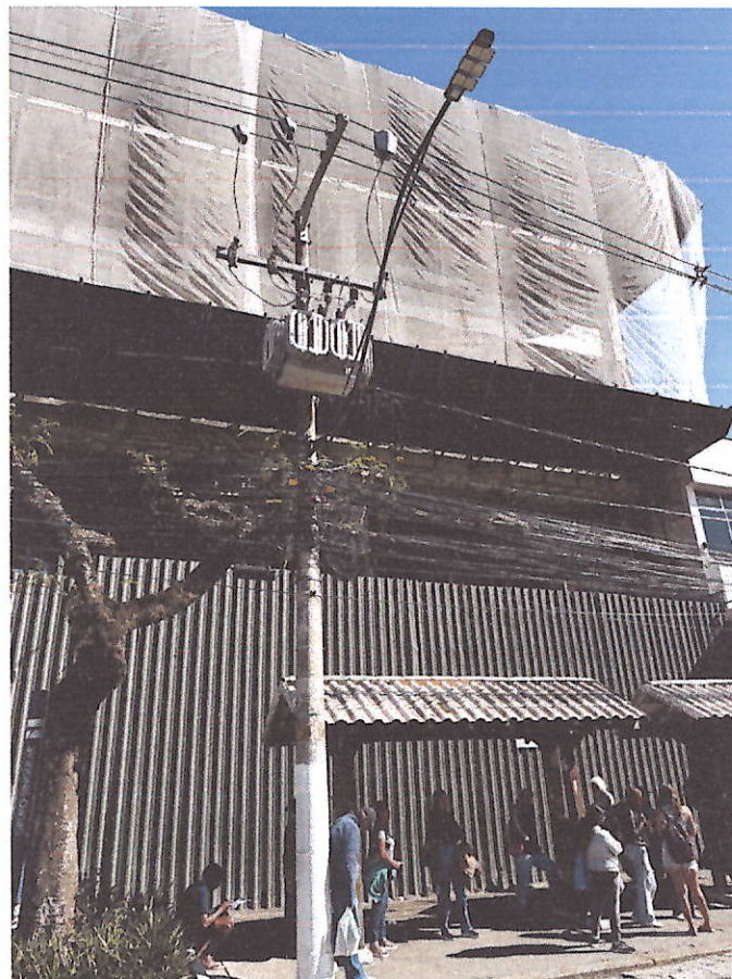
Figura: Poste de distribuição elétrica e iluminação pública existente na Avenida Alberto Braune, em frente ao empreendimento. Fonte: registro fotográfico do autor, 2026.
